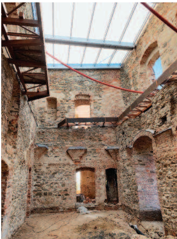
Obr. 12: Stav zdiva po konzervaci, zbytky kleneb chráněny v místech možného zatékání olověným plechem. Zastřešení bylo vloženo do novodobé části koruny zdi. Distance mezi stěnami umožňuje vertikální proudění vzduchu. (Foto M. Karlík)
