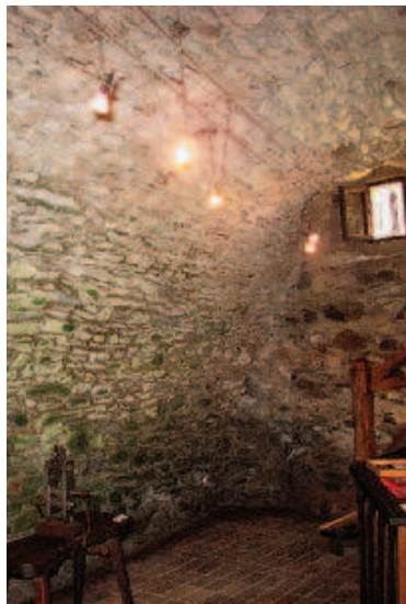
Obr. 7, 8. Vlevo: Vnitřní část paláce. Betonový povrch zadržoval vodu. Ta prosakovala do suterénu spárou mezi asfaltovou izolací a původním zdivem. Vpravo: Suterén paláce. Koroze zdiva poškozovaného opakovaným zatékáním vody. Trvale vlhké prostředí potvrzuje výskyt zelené řasy, stav r. 2016 [2].
