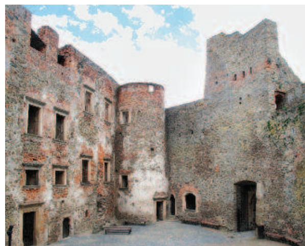
Obr. 3: Dtto, stav r. 2016 [2]. Zřejmý úbytek původních omítek.
