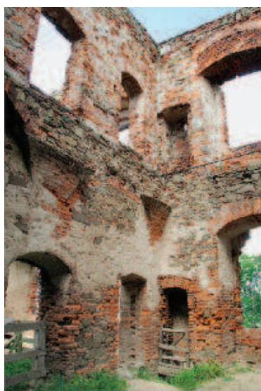
Obr. 4, 5. Vnitřní část paláce, stav r. 2016 [2]. Vlevo: Na místech chráněných zbytky kleneb zachováno torzo původních omítek. Vpravo: Výrazná koroze zdiva v okolí záchodových šachet.
